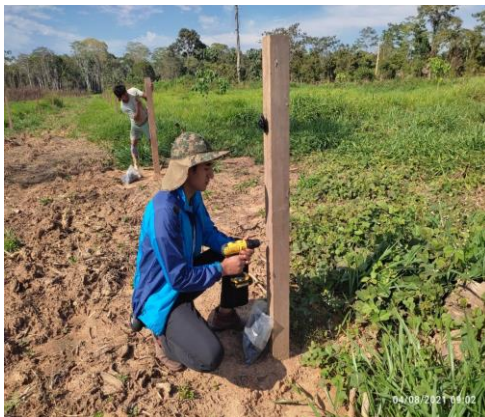
Instalación de cercos eléctricos para el manejo del núcleo genético en la EEA San Bernardo .
