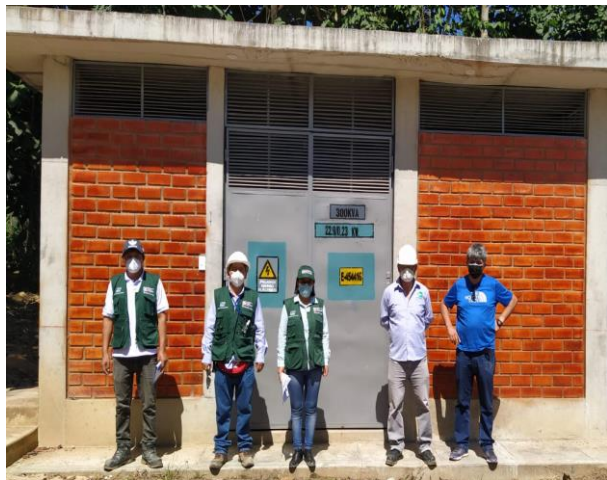
Obra: "Sistema de utilización en media tensión en 22.9 kv trifásico y sub estación de uso exclusivo para el INIA"
